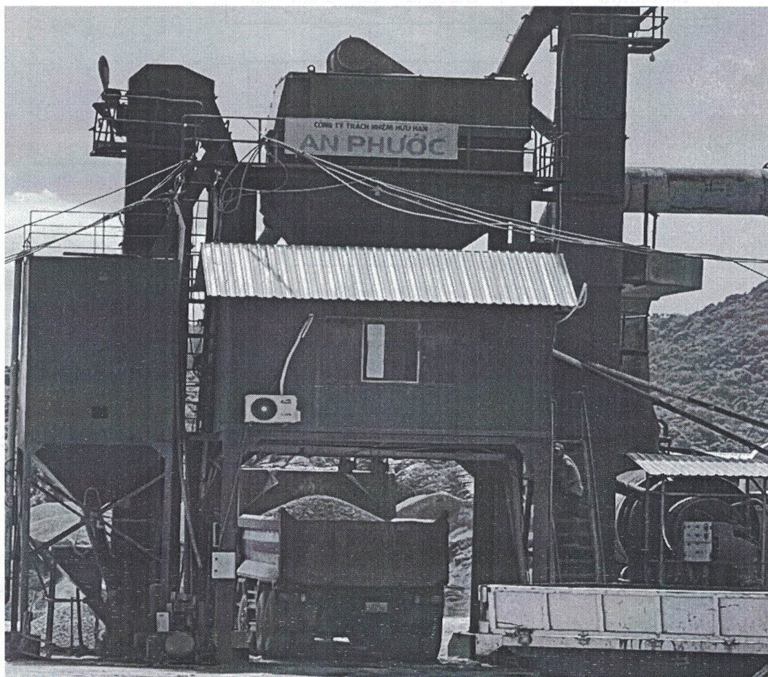
Hình 1-2. Trạm trộn bê tông nhựa nóng 80 tấn sản phẩm/giờ
